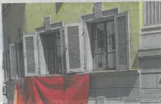
Beim Mädchenzentrum Amazone wurde ein Fenster beschädigt.
